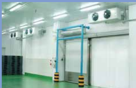
งานระบบห้องเย็น (COLD ROOM SYSTEM)
