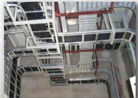
ระบบไฟฟ้าโรงงาน
