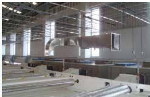
ระบบระบายอากาศ
