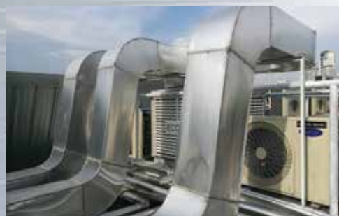
ระบบระบายอากาศ
